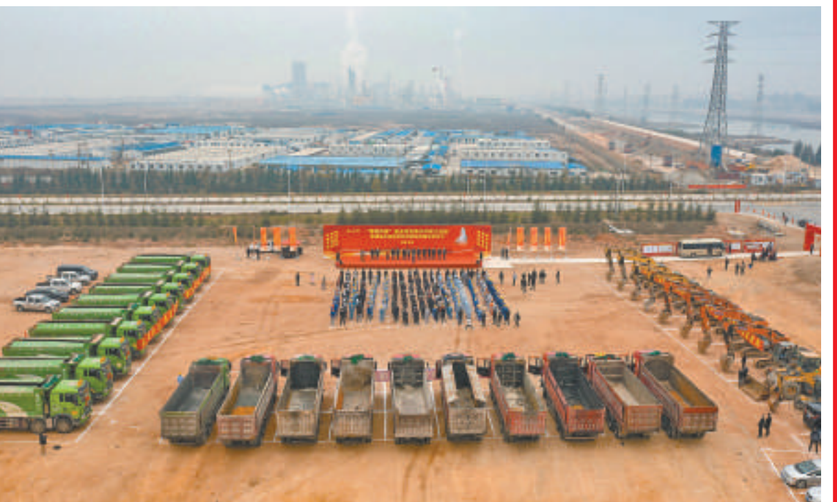
一年之计在于春。我市各级各部门努力跑好“第一棒”、按下“快进键”、夺取“开门红”，重大项目迎来开工复工热潮。图为2月1日福建永荣新材料丙烷制丙烯项目开工现场。全媒体记者 陈斌 摄
