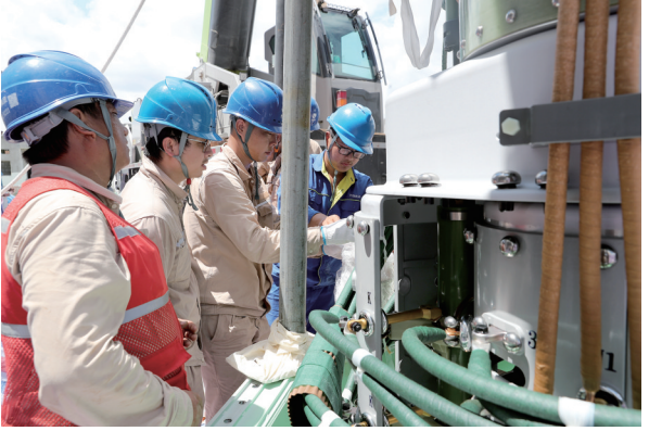
国网莆田供电公司工作人员对变压器进行检查。
