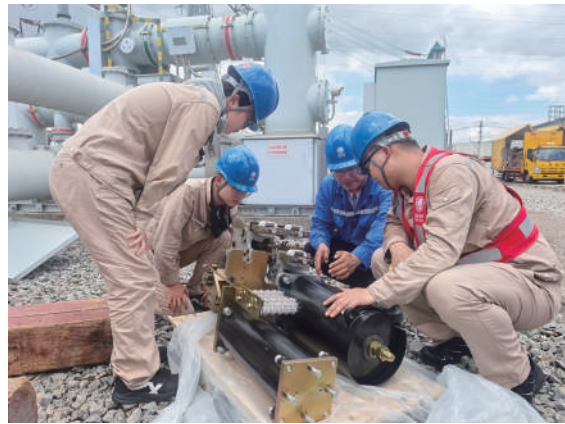
变电检修人员了解断路器机构内部构造。
