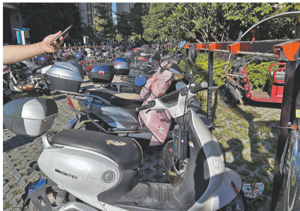
业主反映,该小区电动车集中充电处无雨棚,日晒雨淋存在安全隐患。
