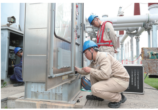
国网莆田供电公司员工在220千伏上庄变电站开展设备检查。
